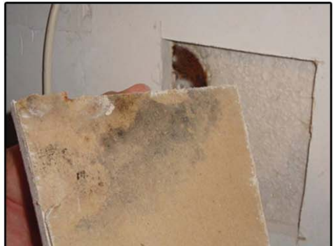
Moisissures à l'endos d'un mur de gypse
