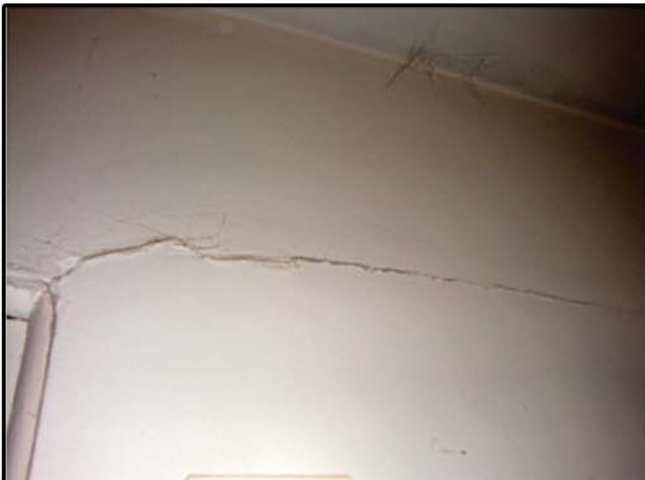
Fissures sur un mur qui peuvent indiquer la présence d'infiltration d'eau
