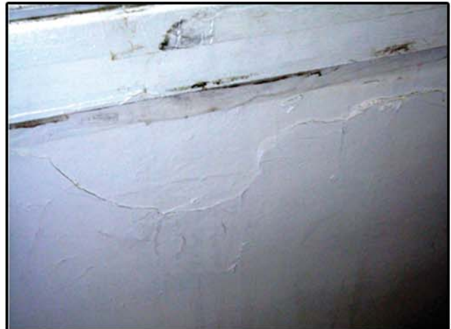
Mur détérioré par les infiltrations d'eau et traces de moisissures
