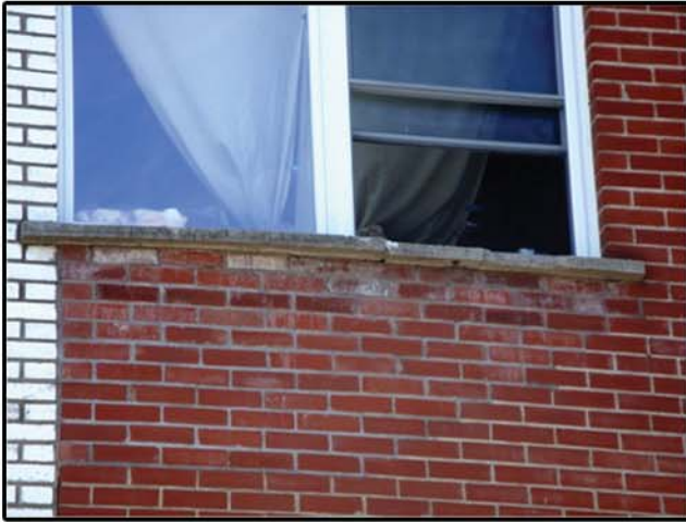
Briques et joints détériorés par des infiltrations d'eau
