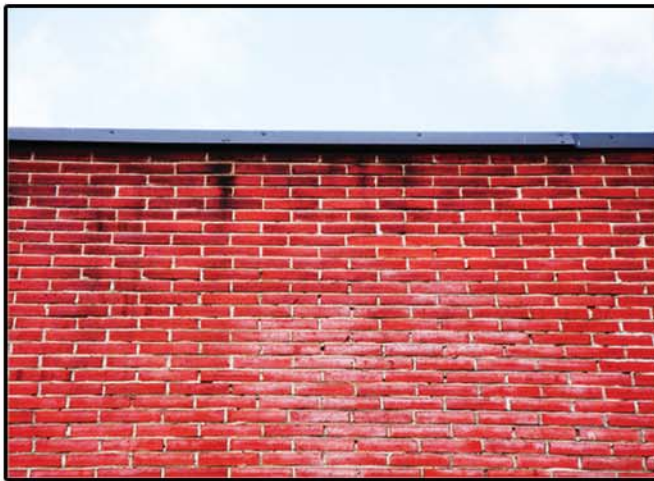
Efflorescences (taches blanchâtres) causées par des infiltrations d'eau
