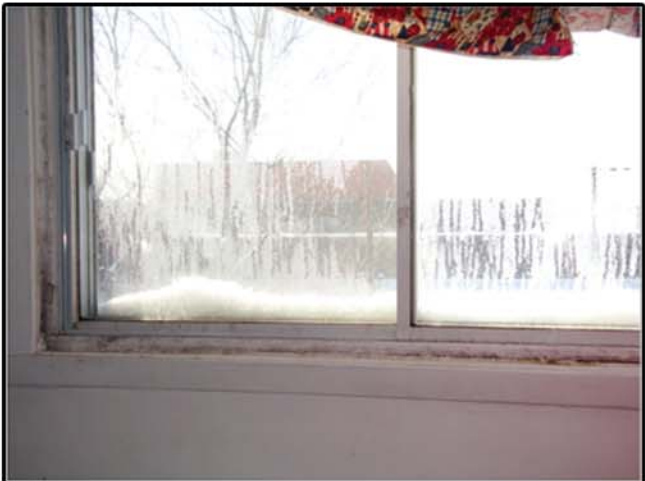
Condensation sur la fenêtre et moisissures sur le rebord
