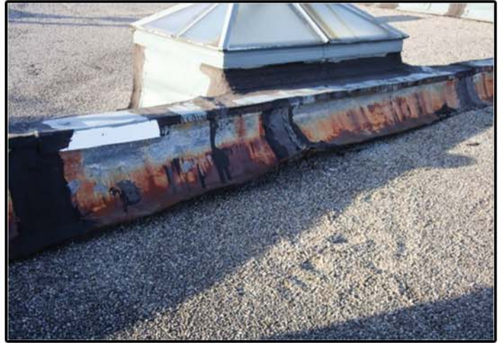
Solin du toit rouillé et soulevé causant des infiltrations d'eau
